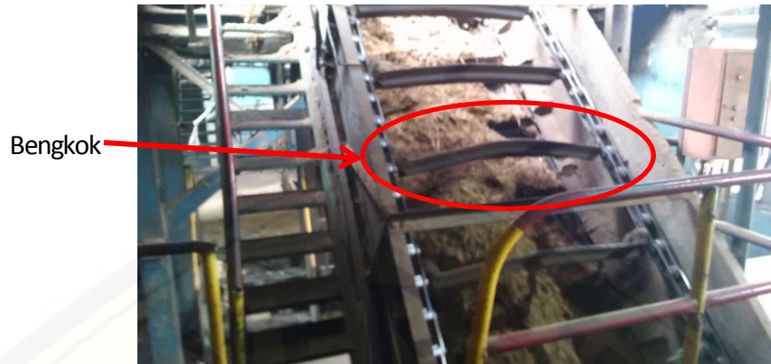
Gambar 2.4 Bagasse conveyor chain yang mengalami bengkok pada scrapper
