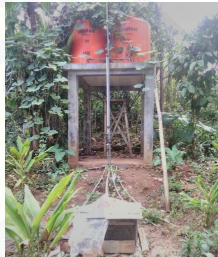
Gambar 20 Tandon Sumur Bor di Dusun Utara Sungai
