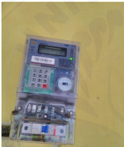
Gambar 19 Meteran listrik untuk menghidupkan pompa air di Sumur Bor Balai Desa
