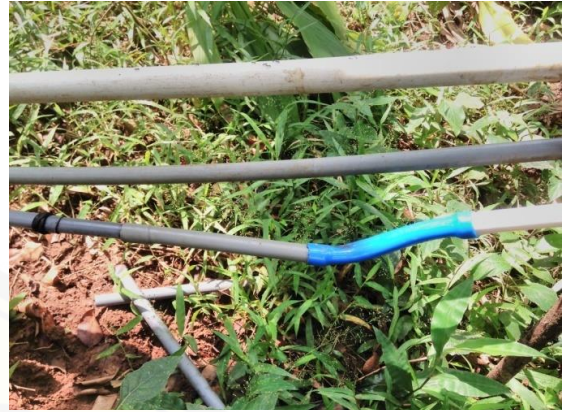
Gambar 18 Pipa yang rusak disambung dengan selang
