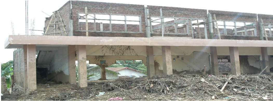
Gambar 2.16 Bangunan SDN 4 Suci berada di sepanjang DAS Kaliputih porak-poranda diterjang banjir bandang Pantai di penghujung tahun 2006. Sumber: Koleksi Foto Humas Pemerintah Kabupaten Jember
