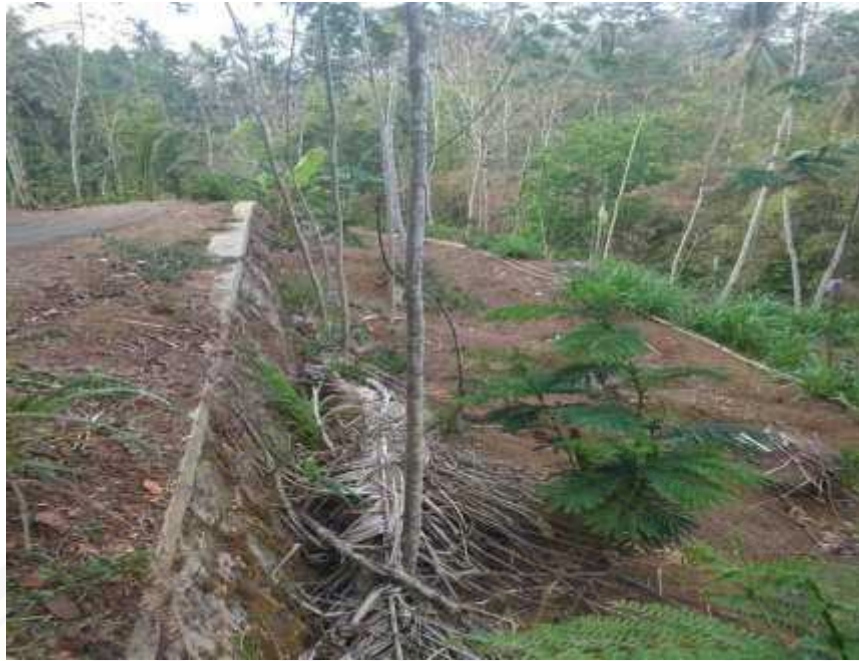
Gambar Pembangunan Tembok Penahan Tanah (TPT) Dusun Gluguh Rt 03/ Rw 12 Desa Karangharjo
