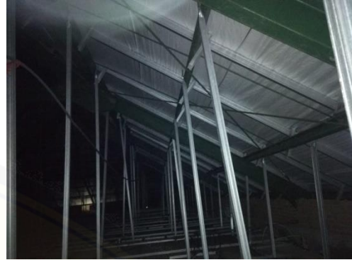
Kondisi struktur atap gedung ki hajar dewantara
