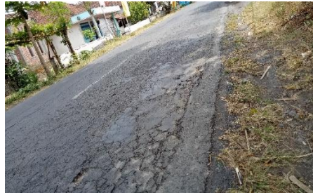
Gambar 2.5 Kerusakan jalan mengembang ( swell ) (Sumber: Dokumentasi Pribadi)
