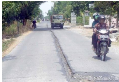
Gambar 2.2 Kerusakan jalan alur ( rutting ) (Sumber: Google Image )
