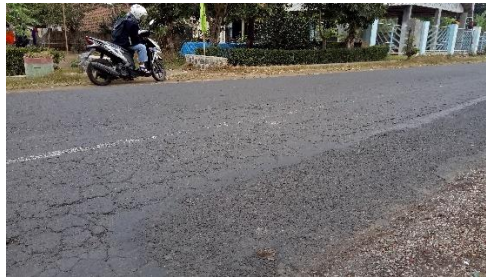
Gambar 2.7 Retak kulit buaya ( alligator cracks ) (Sumber: Dokumentasi Pribadi)
