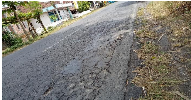
Gambar 5. Pelapukan retak kulit buaya Sumber : dokumentasi pribadi
