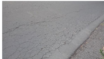
Gambar 2.8 Retak memanjang ( longitudinal crack ) (Sumber: Dokumentasi Pribadi)
