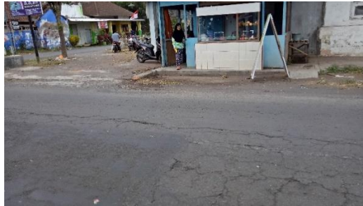
Gambar 2.4 Kerusakan jalan sungkar ( shoving ) (Sumber: Dokumentasi Pribadi)
