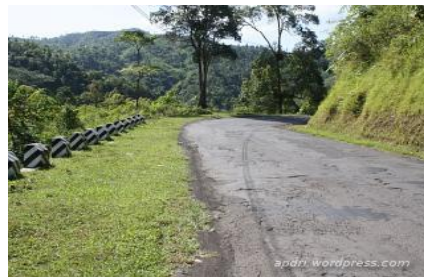
Gambar 2.1 Kerusakan jalan keriting ( corruigation ) (Sumber: Google Image )
