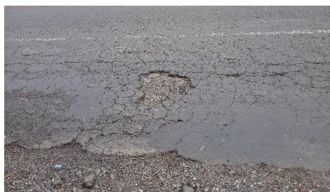
Gambar 2.14 Retak pinggir ( edge cracking ) (Sumber: Dokumentasi Pribadi )
