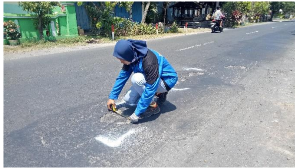
Gambar 2. Pengukuran keamblesan jalan Sumber : dokumentasi pribadi
