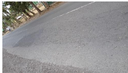
Gambar 2.11 Retak reflektif sambungan ( joint reflection cracks ) (Sumber: Dokumentasi Pribadi)
