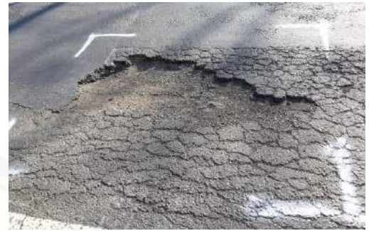
Gambar 2. Kerusakan jalan lubang Sta 238+625 Sumber : Dokumentasi pribadi
