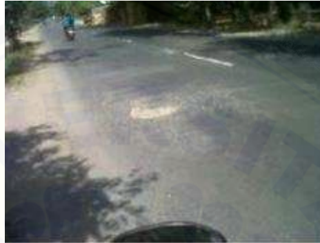
Gambar 2. 10 Kerusakan Amblas (Sumber : Jurnal. Identifikasi Jenis Kerusakan Jalan Pada Studi Kasus Ruas Jalan Kedungmundu-Meteseh
