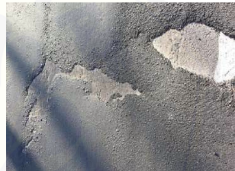
Gambar 4. Kerusakan jalan terkelupas Sta 240+900 Sumber : Dokumentasi pribadi
