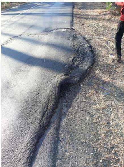
Gambar 9. Kerusakan jalan kegemukan aspal sta 234+350 Sumber : Dokumentasi pribadi
