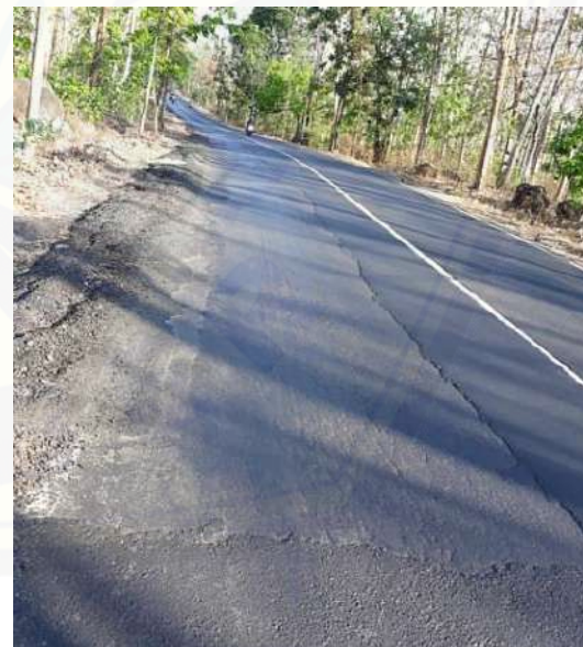
Gambar 10. Kerusakan jalan kehilangan permukaan dan kegemukan aspal sta 234+325 – 234+350 Sumber : Dokumentasi pribadi
