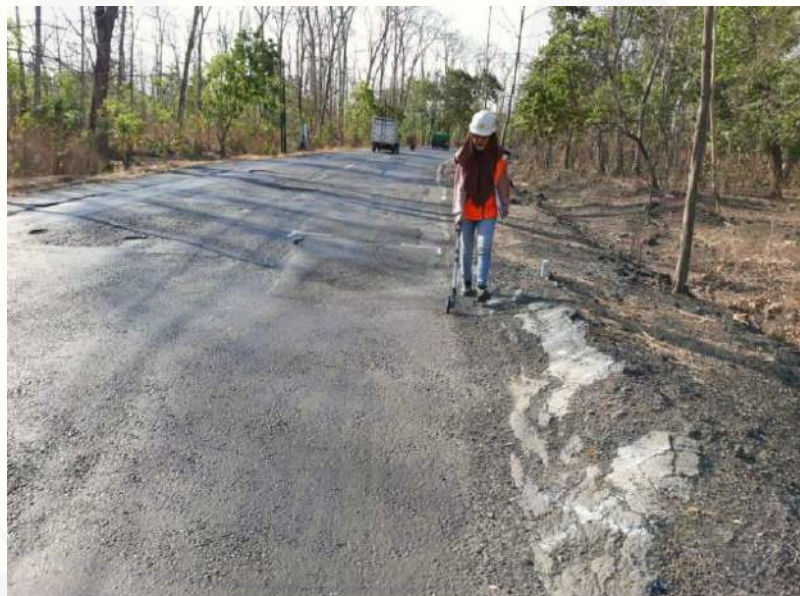
Gambar 12. Pengukuran luas kerusakan jalan lubang di sta 239+900 menggunakan walking distance Sumber : Dokumentasi pribadi
