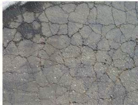
Gambar 2. 9 Retak Susut (Sumber: Jurnal. Identifikasi Jenis Kerusakan Jalan Pada Studi Kasus Ruas Jalan Kedungmundu-Meteseh)
