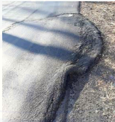
Gambar 2. 11 Kerusakan Jembul (Sumber: dokumentasi pribadi)
