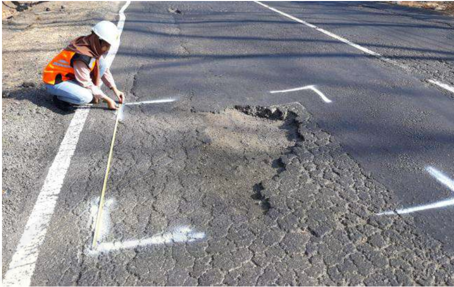
Gambar 11. Pengukuran luas kerusakan jalan lubang di sta 238+625 menggunakan meteran Sumber : Dokumentasi pribadi
