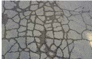
Gambar 2. 3 Retak kulit buaya (Sumber: dokumentasi pribadi)
