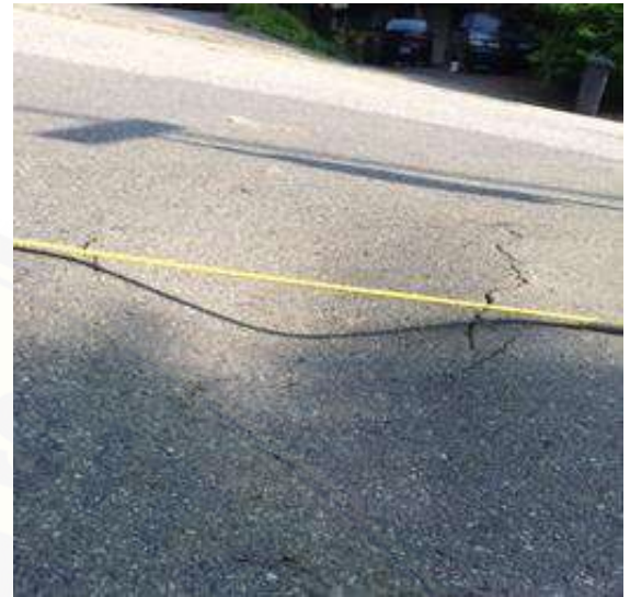
Gambar 8. Kerusakan jalan ambles 242+825 Sumber : Dokumentasi pribadi
