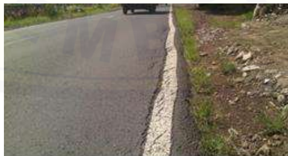
Gambar 2. 4 Retak pinggir (Sumber: dokumentasi pribadi)
