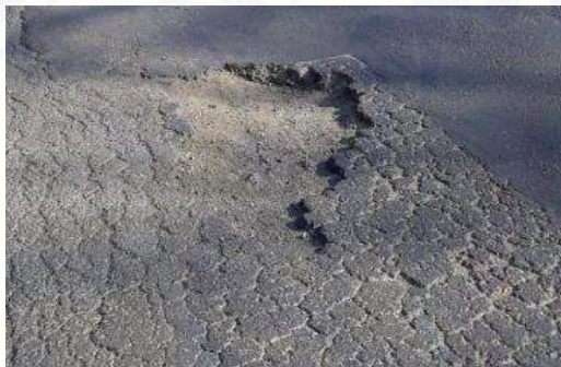
Gambar 3. Kerusakan jalan lubang Sta 238+625 Sumber : Dokumentasi pribadi
