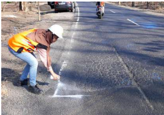
Gambar 1 Penandaan jalan yang rusak dengan pilox Sumber : Dokumentasi pribadi
