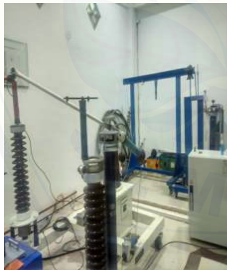
Peralatan Pembangkit Tegangan Tinggi
