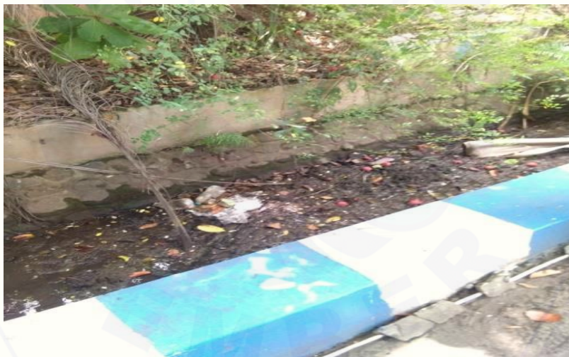
Terdapat Sedimentasi Pada Saluran
