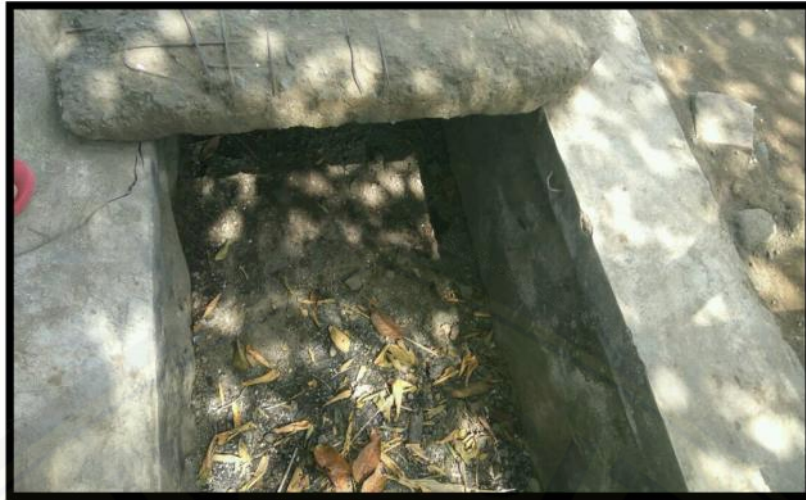
Gambar 6. Kondisi eksisting saluran drainase
