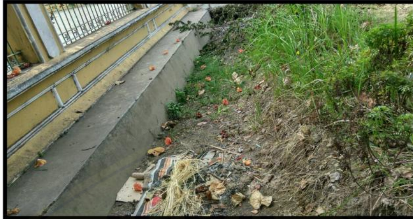
Gambar 1. Kondisi eksisting saluran drainase
