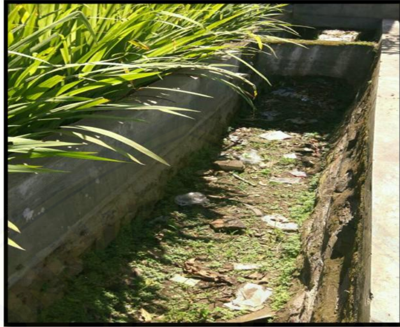
Gambar 4. Kondisi eksisting saluran drainase
