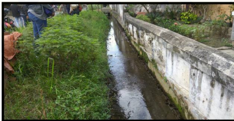
Gambar 3. Kondisi eksisting saluran drainase
