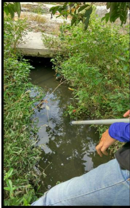
Gambar 14. Kondisi eksisting saluran drainase
