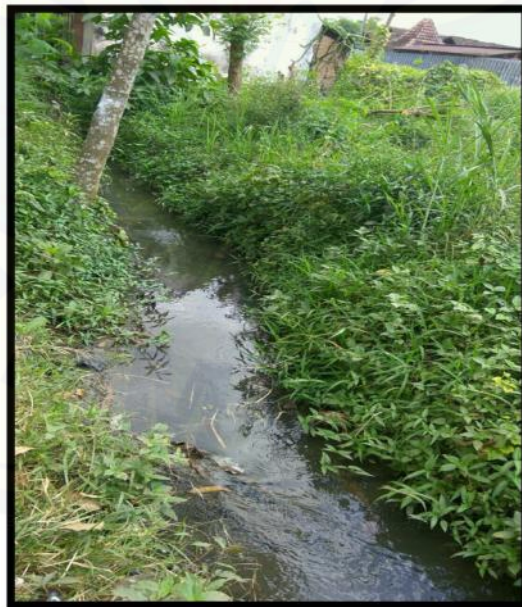
Gambar 15. Kondisi eksisting saluran drainase
