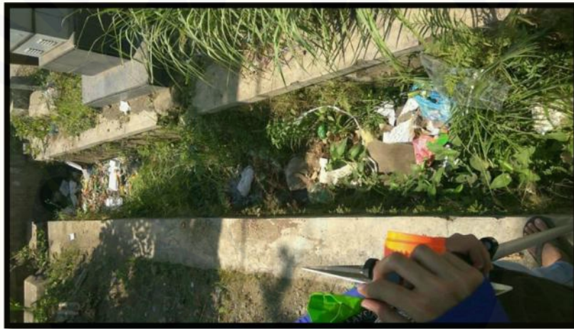
Gambar 2. Kondisi eksisting saluran drainase
