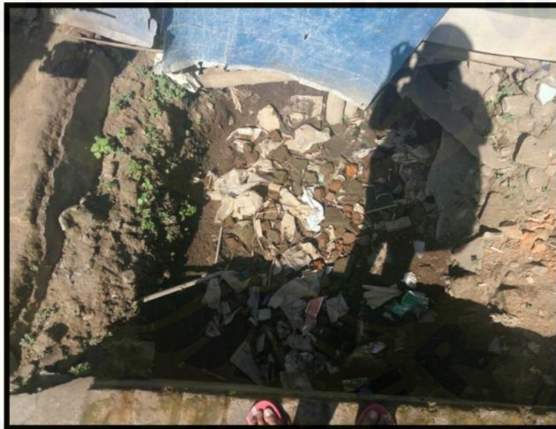
Gambar 7. Kondisi eksisting saluran drainase
