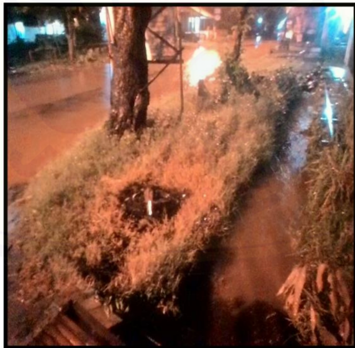
Gambar 4. Kondisi drainase sebelah kanan
