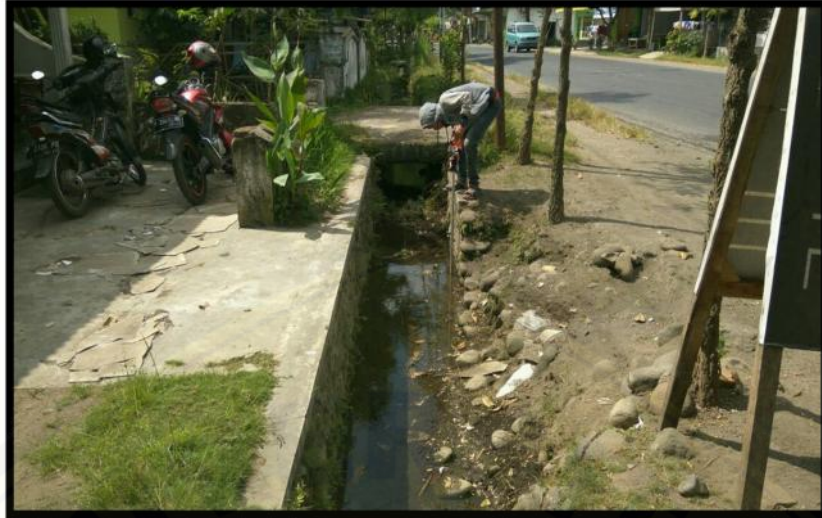
Gambar 8. Kondisi eksisting saluran drainase
