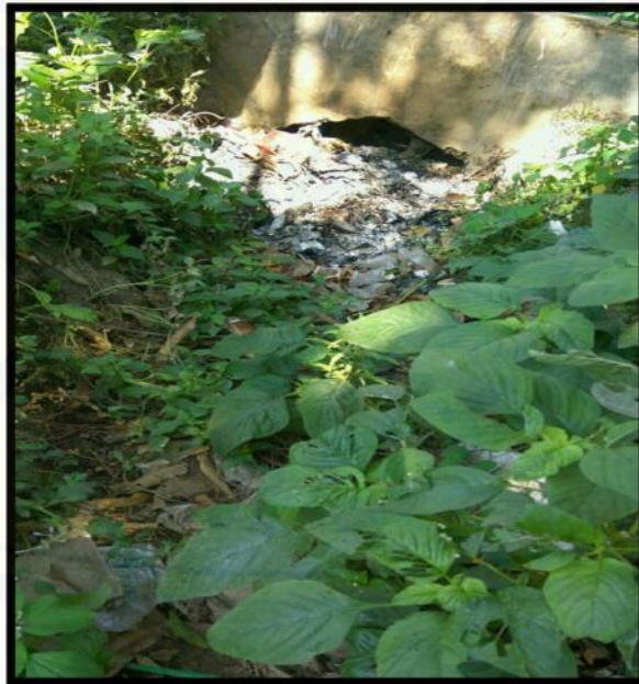
Gambar 17. Kondisi eksisting saluran drainase
