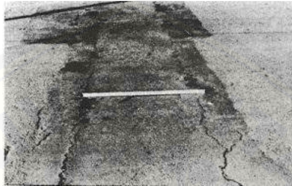
Gambar 2.6 Kerusakan tambalan (Sumber : Google Images, 2017)
