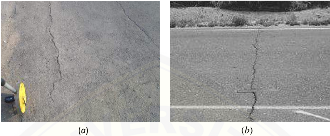
(a) Retak Memanjang; (b) Retak Melintang
