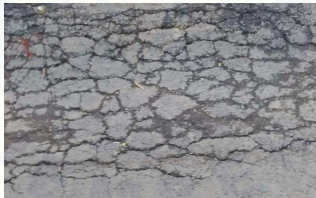
Gambar 2.1 Kerusakan retak kulit buaya (Sumber : Kurnia,2016)
