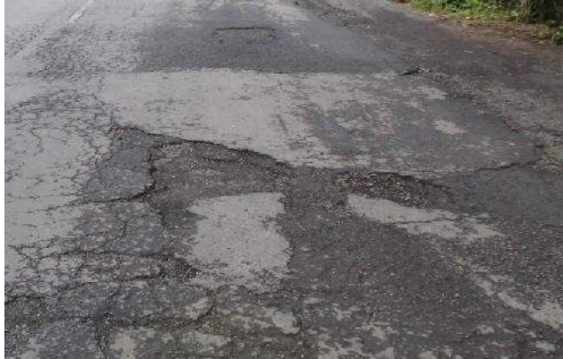
Gambar 2.9 Kerusakan retak selip (Sumber : Kurnia,2016)
