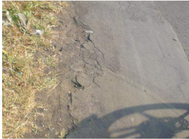
Gambar 2.4 Kerusakan retak pinggir (Sumber : Kurnia,2016)
