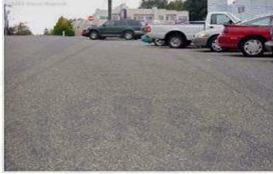
Gambar 2.2 Kerusakan gelombang atau keriting (Sumber : Google Images, 2017)
