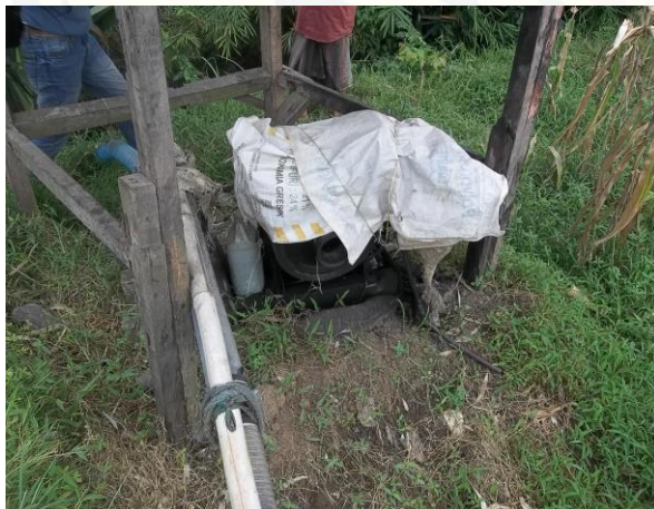
Gambar 3. Pompa air irigasi
