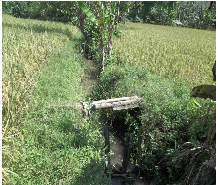
Gambar 2. Kondisi saluran air di Desa Curahtakir
