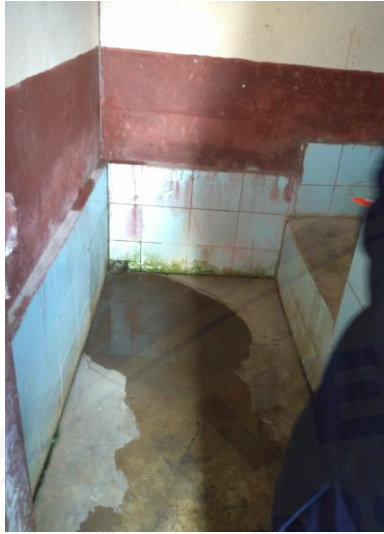
Gambar 1. Toilet dengan lantai yang tidak menggunakan porselen
