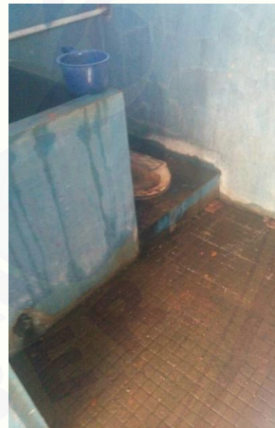
Gambar 4. Toilet dengan menggunakan jenis TPA permanen
