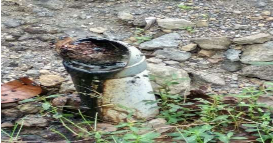
Gambar 2.3. Pipa saluran gas metana di TPA Pakusari
