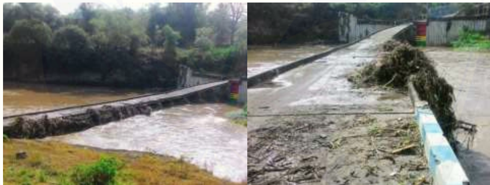
Gambar 1.2 Kondisi Jembatan setelah Hujan Lebat
