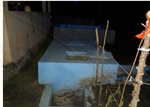
Gambar 10. IPAL di RPH Kaliwates
