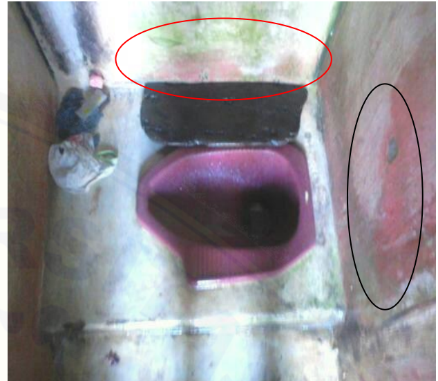
Gambar 4.2 Salah satu contoh rumah dengan sarana sanitasi dasar berupa jamban yang berlumut dan dinding tidak kedap air
