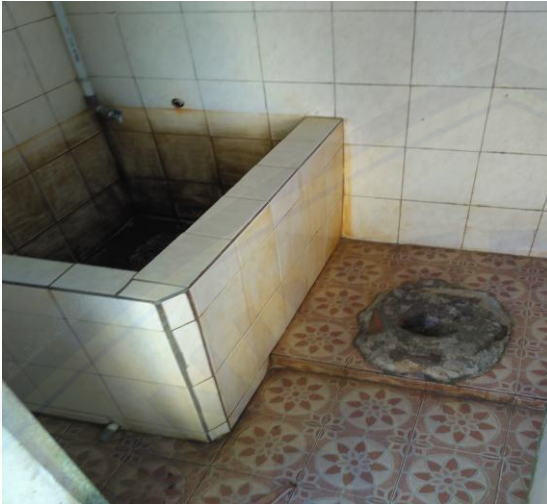
Gambar 9. Kamar Mandi tidak memiliki Jamban
