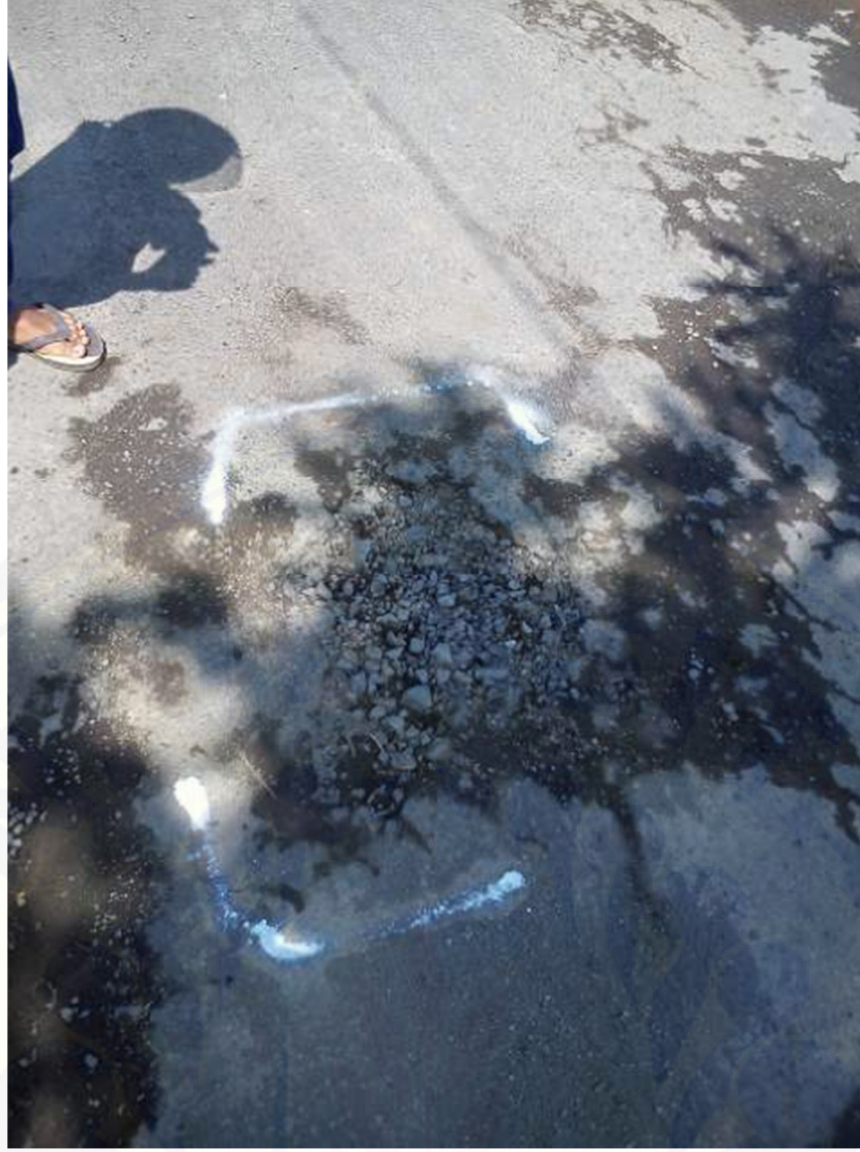
GAMBAR Kerusakan >50mm
