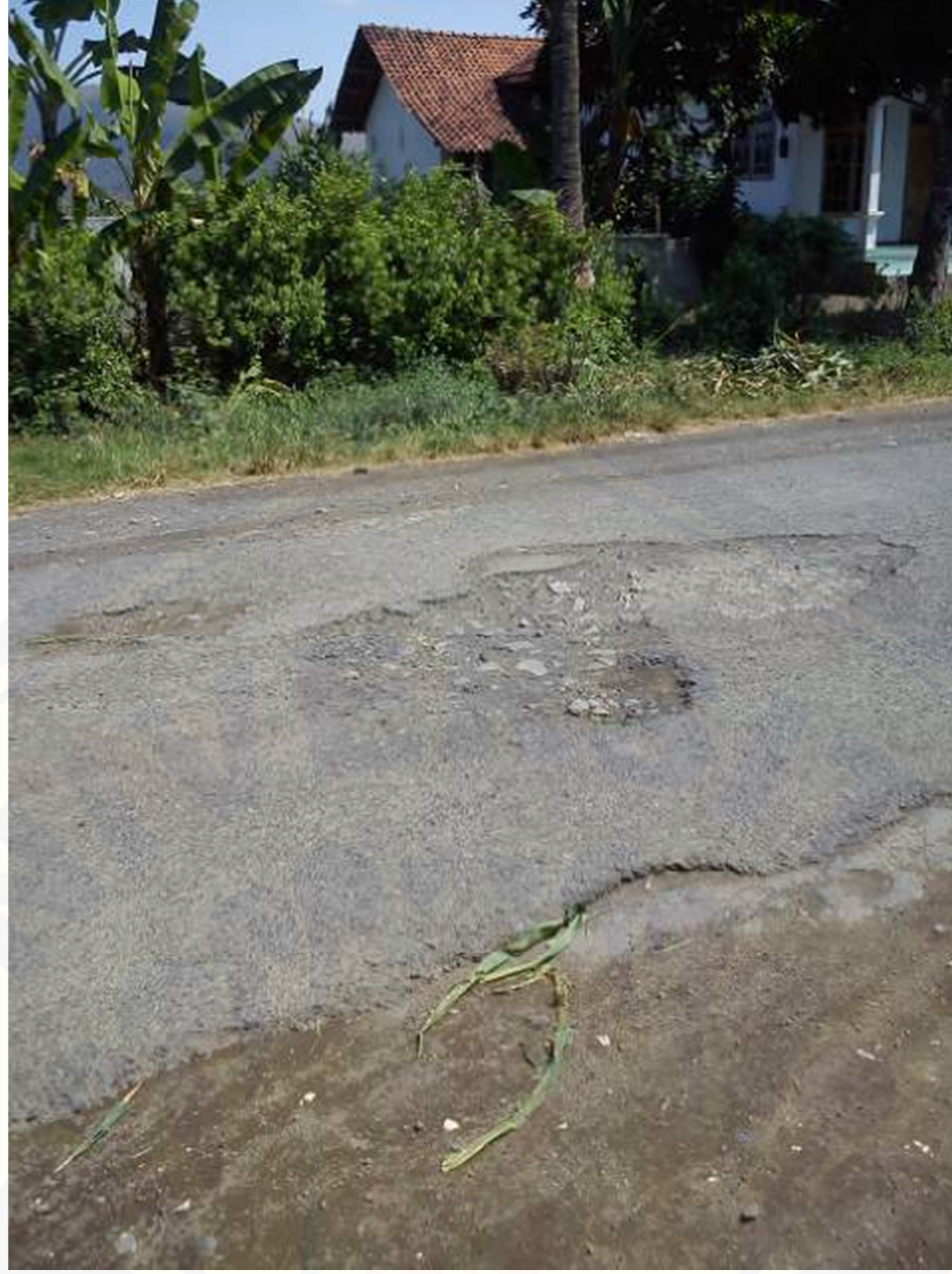
GAMBAR Kerusakan >50mm
