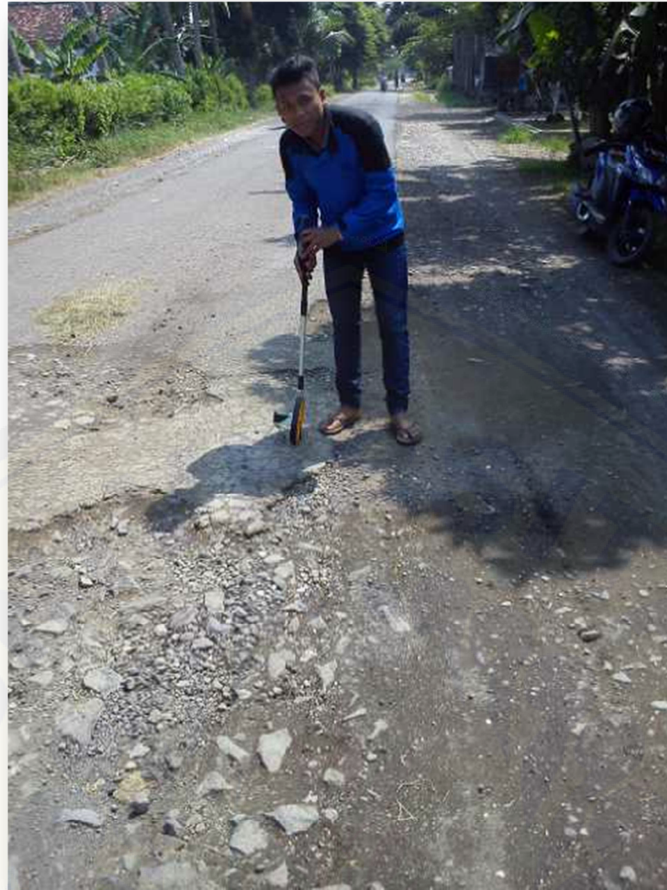
GAMBAR Kerusakkan retak kuliat buaya
