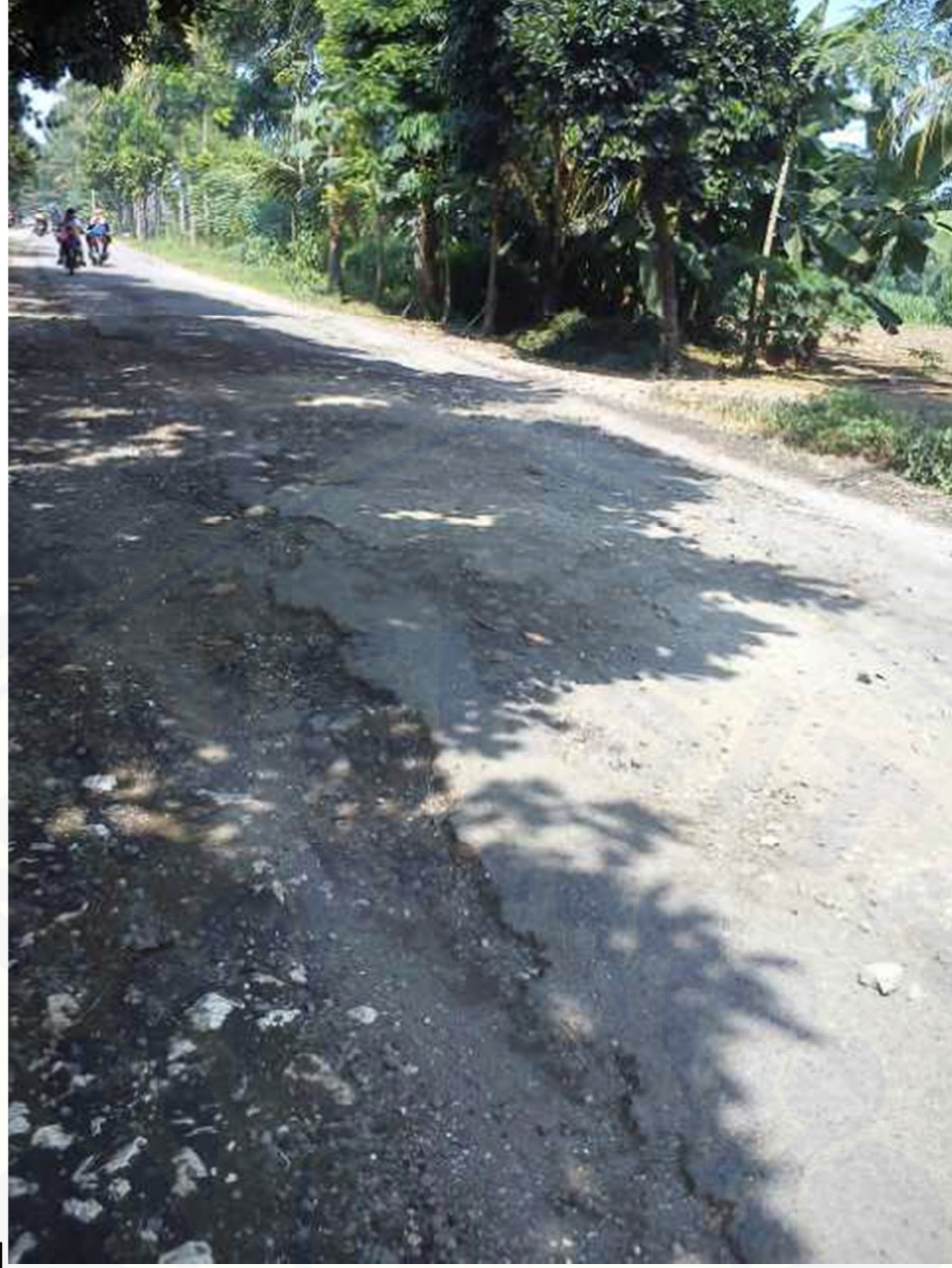
GAMBAR Kerusakan >50mm
