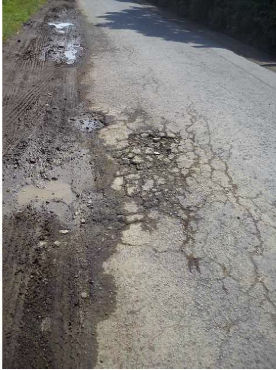
GAMBAR Kerusakan pinggir <50mm
