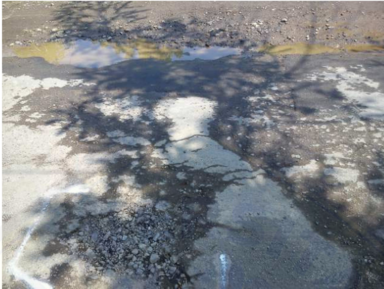
GAMBAR Kerusakan >50mm
