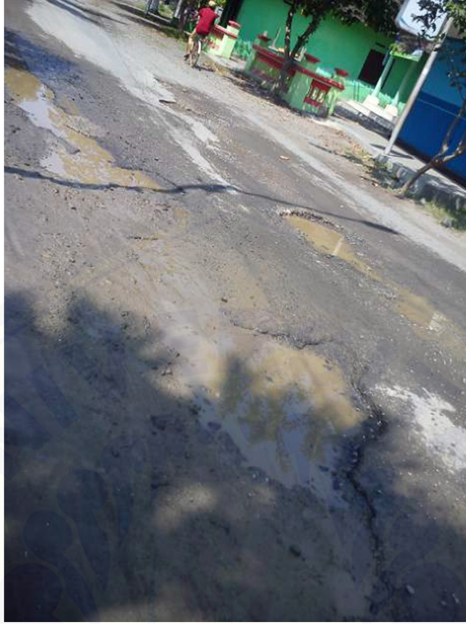
GAMBAR Kerusakan <50mm
