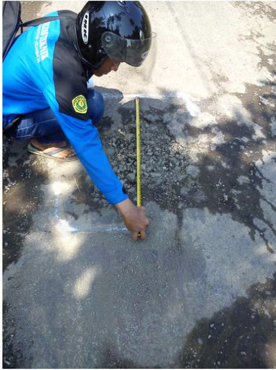
GAMBAR Kerusakan >50mm
