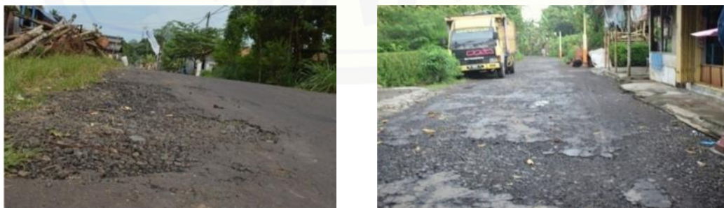
Gambar 3.2 contoh kerusakan yang terjadi di Ruas Jalan Kemundung
