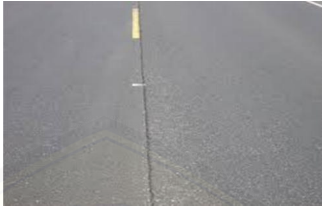
Gambar 2.7 Retak sambungan jalan
