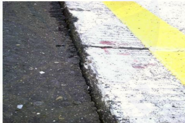
Gambar 2.6 Retak Sambungan Bahu Jalan
