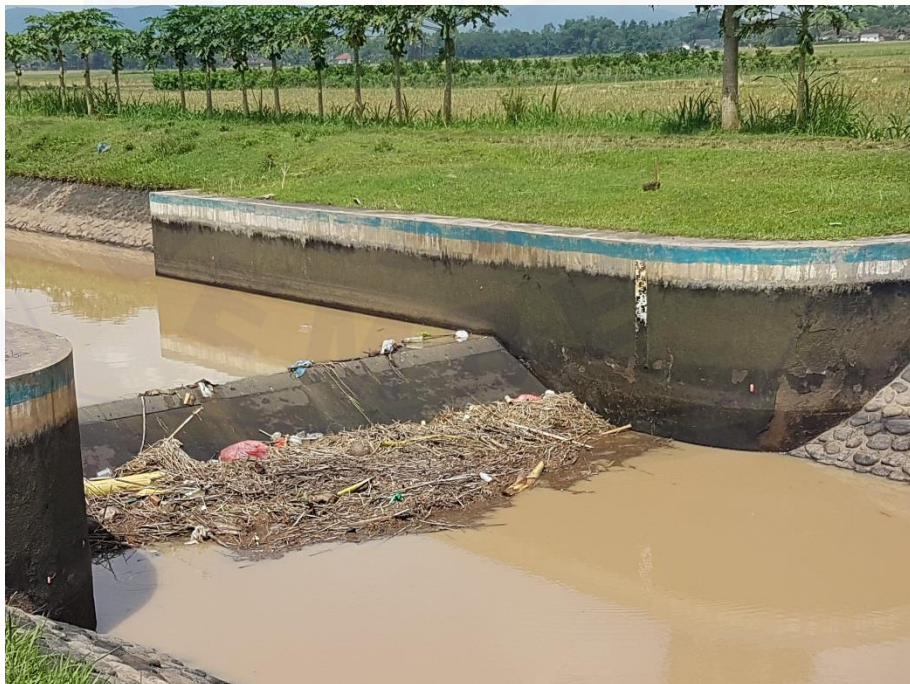
Gambar A.6 Contoh kondisi bangunan ukur
