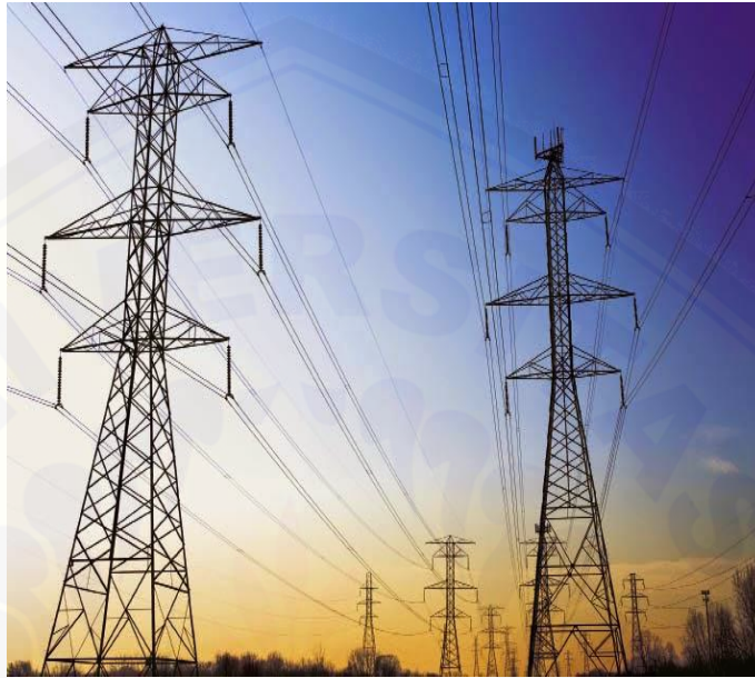
Gambar 2.2 Saluran Udara Tegangan Tinggi (M Ridwan Anas, 2015)
