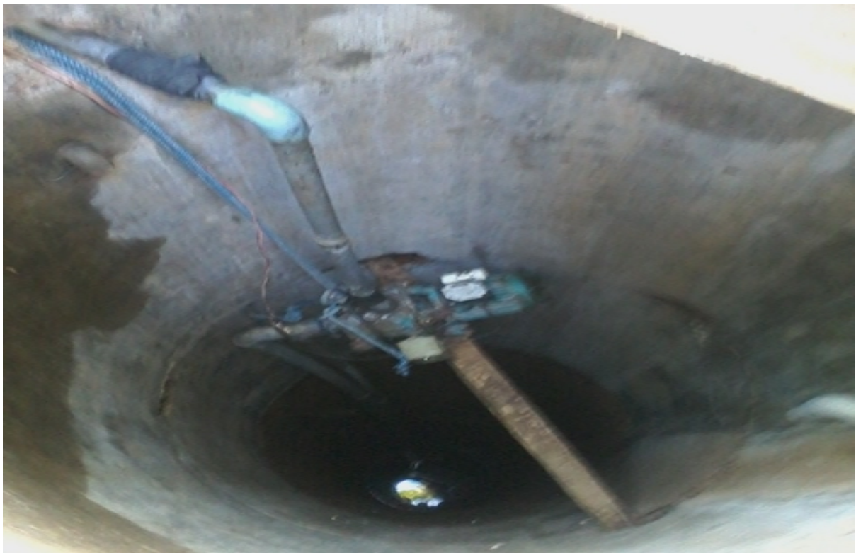
Sistem Pengairan menggunakan mesin water pump
