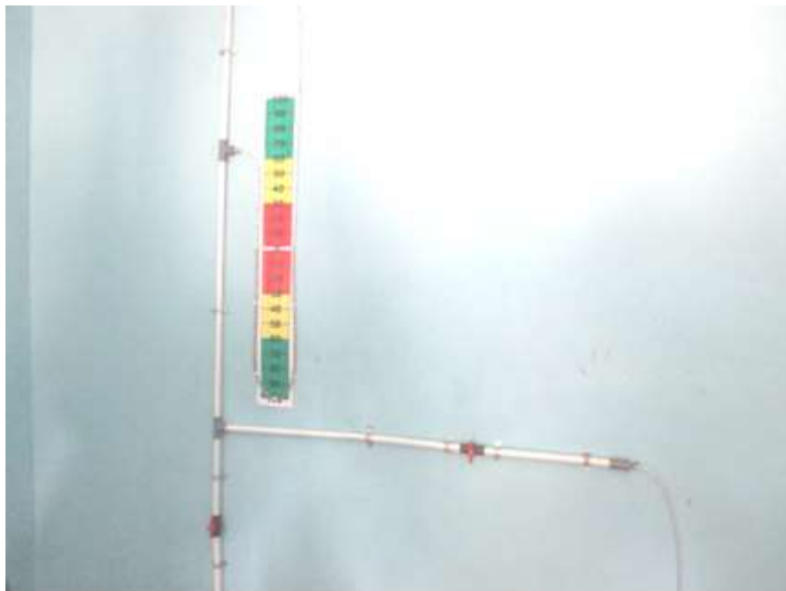
Gambar 15. Instalasi Pipa Saluran Biogas dan Manometer
