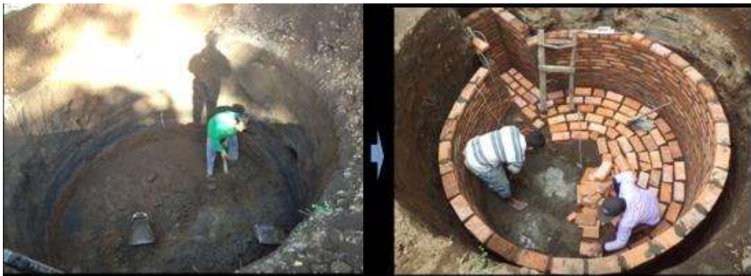
Gambar 11. Peenggalian Lubang Reaktor dan Pemasangan Dinding Batu Bata pada Reaktor Biogas di Lokasi Pengabdian
