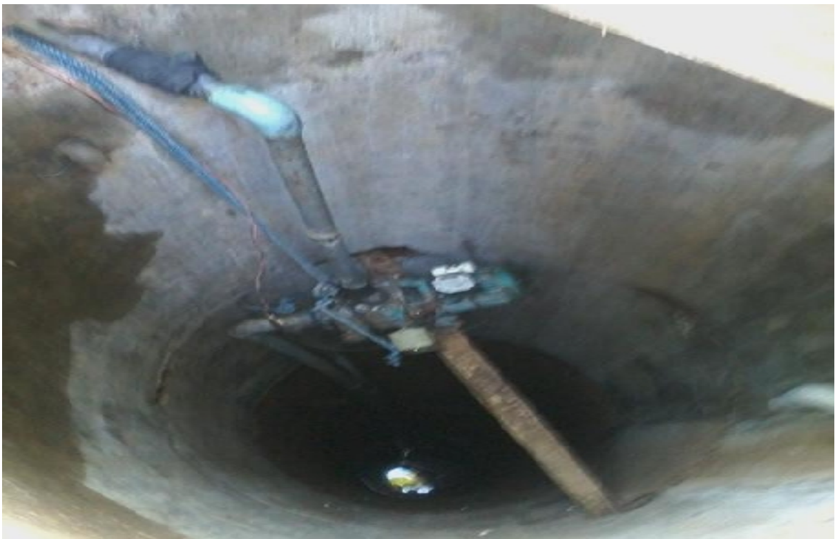
Sistem Pengairan menggunakan mesin water pump
