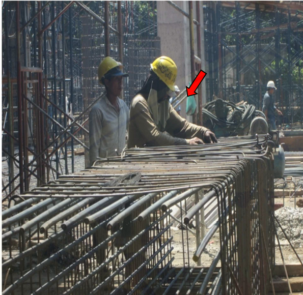
Unsafe Action (APD) tidak memakai sarung tangan
