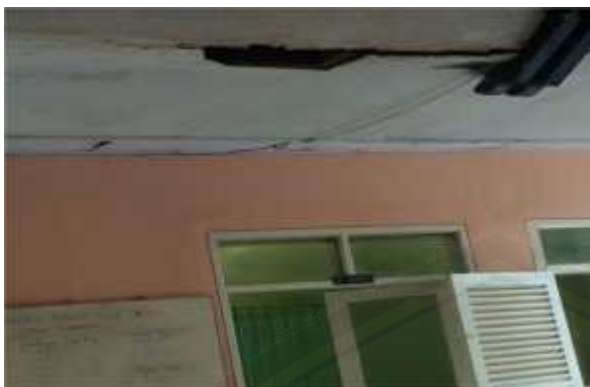
( dokumentasi atap gedung puskesmas yang bocor )
