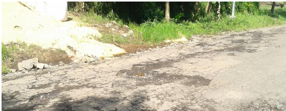
Gambar 2.9 Retak pinggir ( edge crack )
