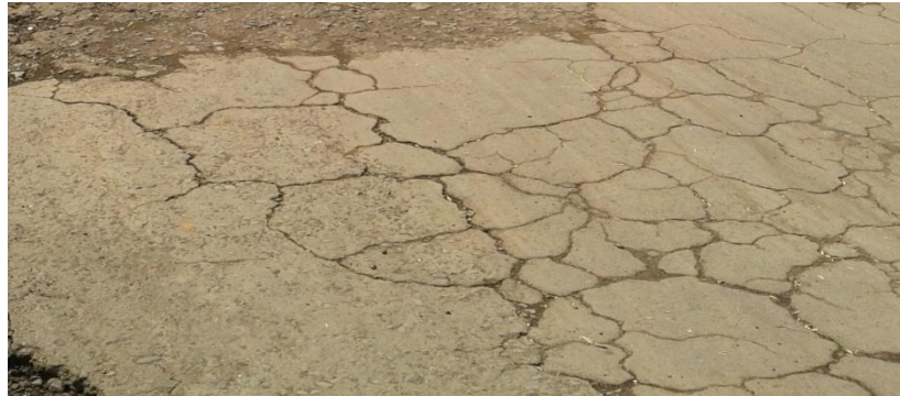
Gambar 2.8 Retak Kulit Buaya ( alligator crack )
