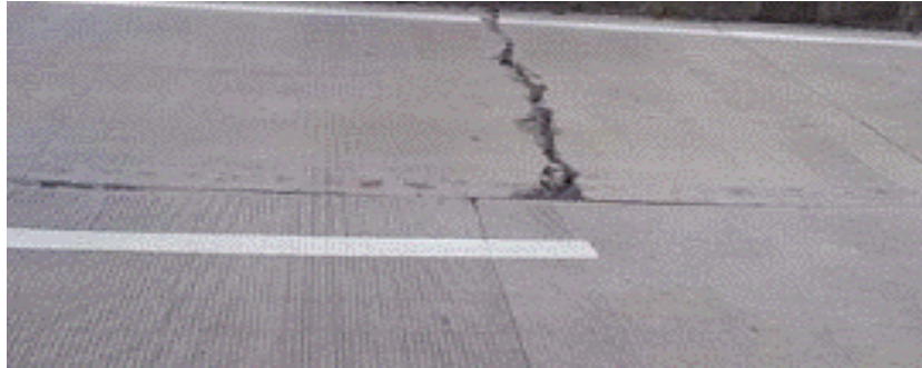
Gambar 2.10 Retak sambungan bahu dan perkerasan ( edge joint crack )
