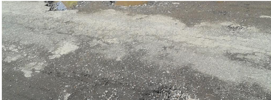
Gambar 2.11 Retak sambungan jalan ( lane joint crack )
