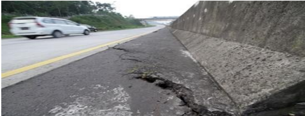
Gambar 2.12 Retak sambungan pelebaran jalan ( widenning cracks )
