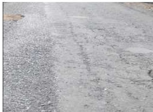
Gambar 2.4 Retak Sambungan Bahu Jalan
