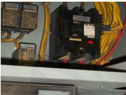
Gambar 3. Breaker dalam posisi off
