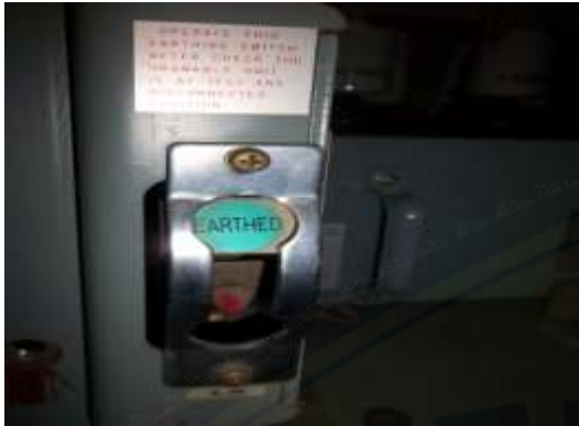
Gambar 7. Energi telah dikendalikan
