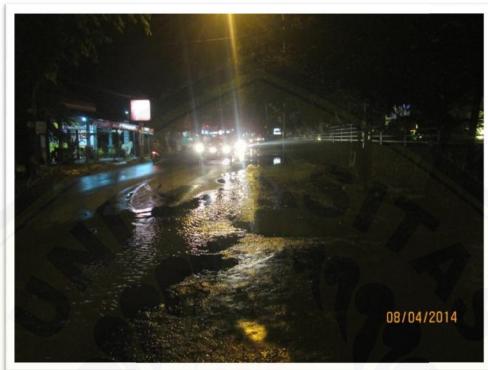
Gambar 1. Kondisi Genangan pada jalan Karimata pada tanggal 8 April 2014
