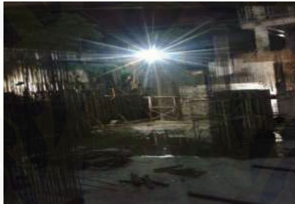
Gambar 4.5 Kurangnya penerangan pada area kerja
