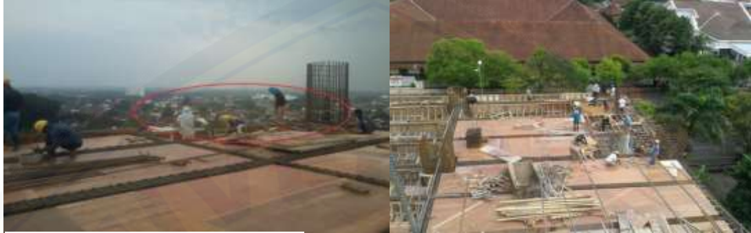
Gambar 4.1 Pekerjaan bekesting (Kurang nya pembatas area kerja diketinggian)
