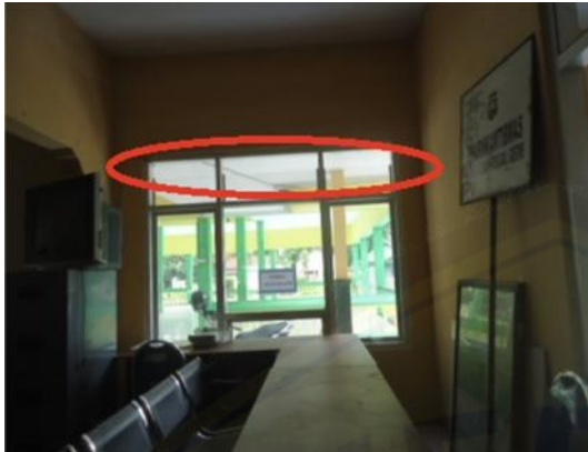
Gambar 17. Ventilasi di ruang kerja kantor kelurahan Tegal Gede
