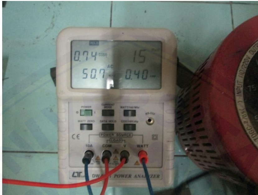
Pengujian tanpa beban motor rewinding pada tegangan 50 V
