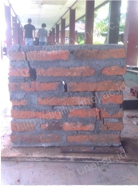
Gambar 15 Keretakan Akibat Kuat Geser
