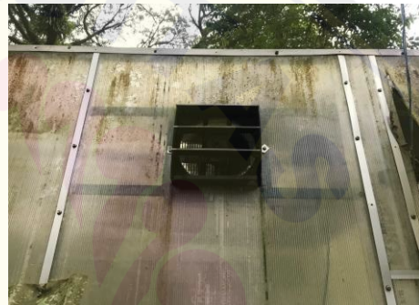
(d) Exhaust Fan
