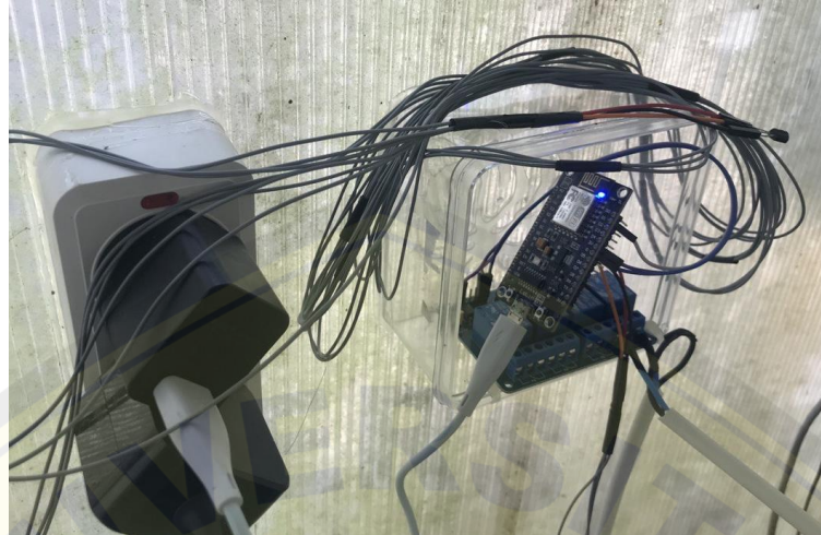
Rangkaian sistem kontrol suhu ruang Greenhouse
