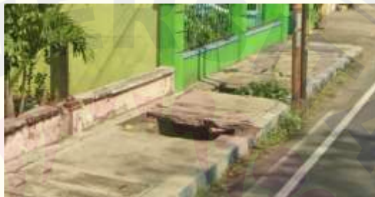
Gambar 4. 19 Kondisi Trotoar pada Tipe Jalan 2/2 UD
