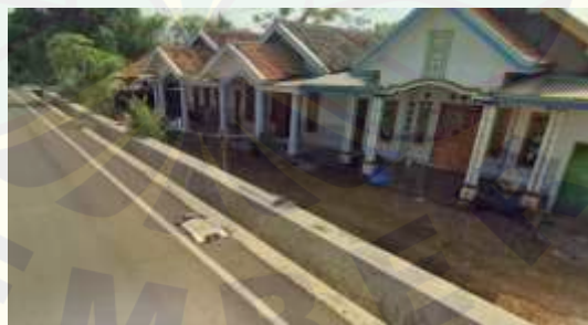
Gambar 4. 9 Kondisi Bahu Jalan pada Tipe Jalan 2/2 UD
