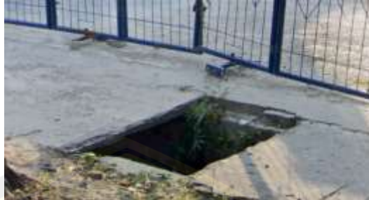
Gambar 4. 4 Kondisi Selokan Samping pada Tipe Jalan 4/2 UD
