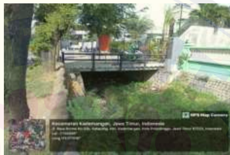
Gambar 4. 10 Kondisi Selokan Samping pada Tipe Jalan 2/2 UD
