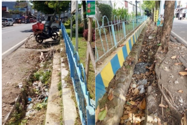
Gambar 4.6 Kondisi Drainase Bagian Luar Lapangan (Sumber: Data Primer, 2023)
