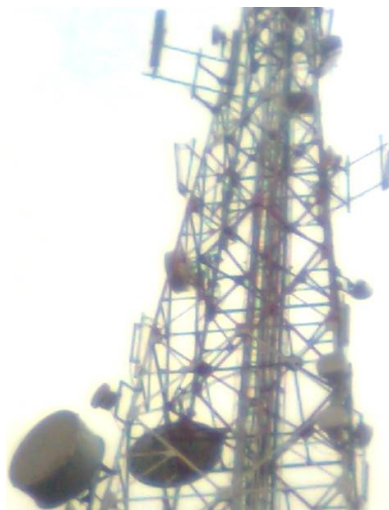
Gambar E.3 Antena BTS Cokroaminoto
