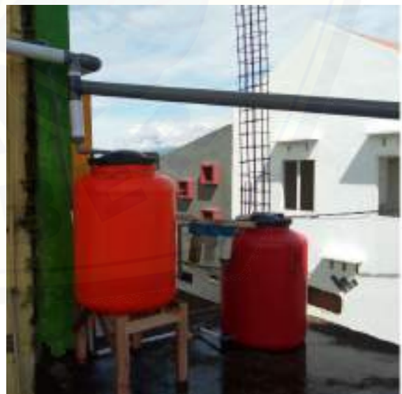
Gambar8. Dua Buah Tandon Berkapasitas Masing-Masing 350 Liter, Filter di Antara Kedua Tandon, dan Pipa-Pipa PVC
