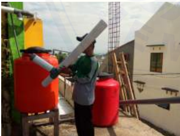
Gambar 9. Pipa untuk Menyalurkan Kelebihan Air Hujan yang Terlepas Saat Terjadi Hujan dan Angin
