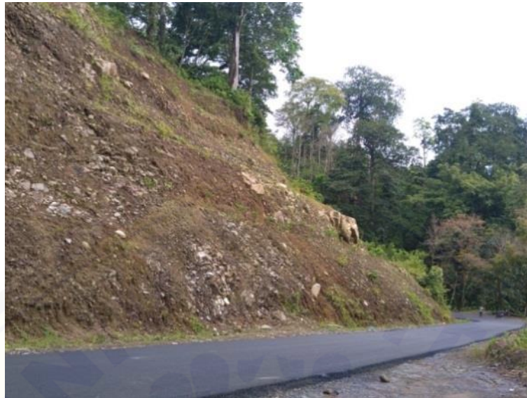
Gambar 1. Kondisi eksisting lereng
