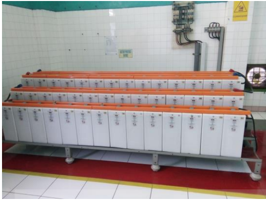
Gambar.2 Sel baterai NiCd pada Gardu Induk Jember dengan bejana (container) terbuat dari plastik ditempatkan dalam rak besi yang diisolasi.
