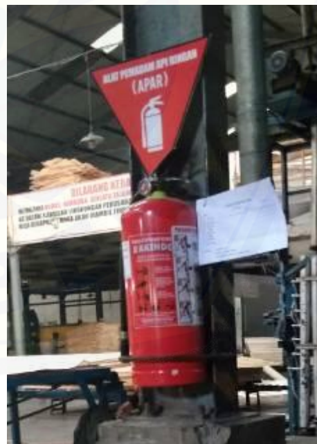
Gambar 24. APAR diletakkan pada posisi yang mudah dilihat dan jelas
