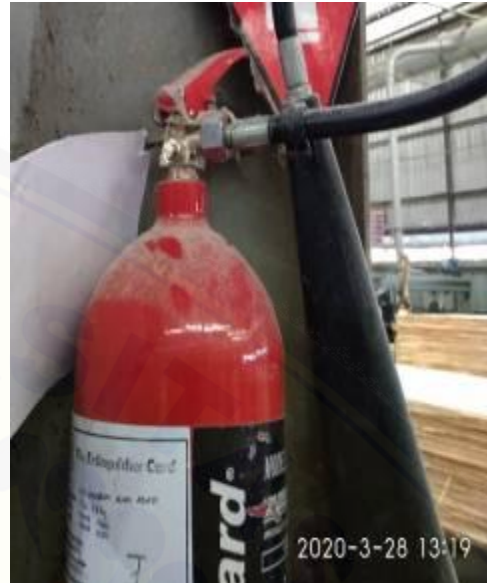
Gambar 2. APAR tidak memiliki manometer
