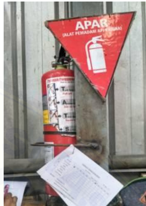
Gambar 26. APAR dipasang menggantung dengan konstruksi penguat
