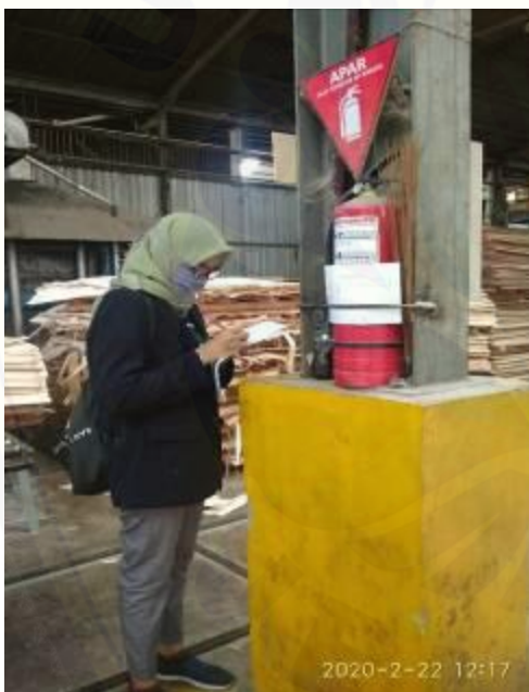
Gambar 7. Observasi kondisi APAR
