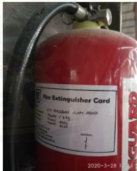
Gambar 4. Tanda pengisian ulang APAR tidak lengkap
