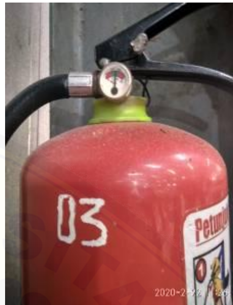
Gambar 14. APAR memiliki tekanan (Jarum pada manometer ada di area hijau)
