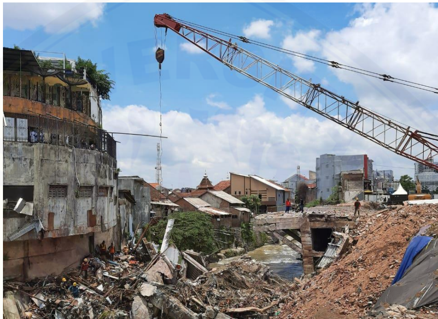
Gambar 1.1 Amblasnya tanah di Jl. Sultan Agung, Jompo, Jember
