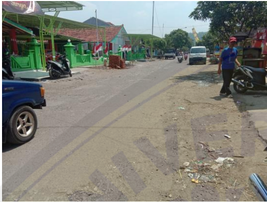
Gambar 5. Kondisi jalan yang berlubang menuju pasar
