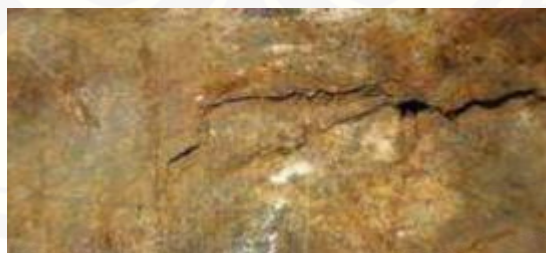
Gambar 2.4 Korosi Tegangan (Utomo, 2009)
