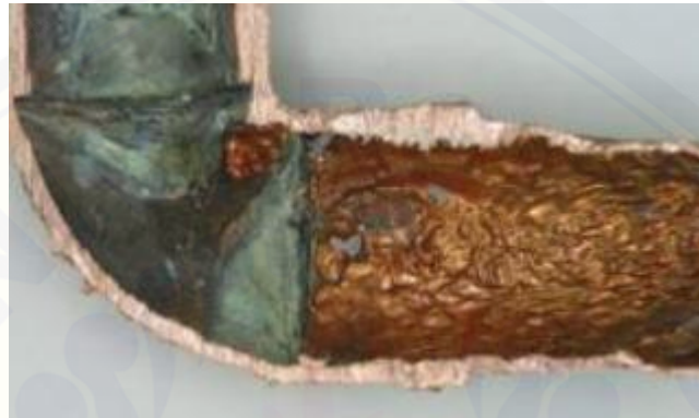
Gambar 2.3 Korosi Erosi (Utomo, 2009)
