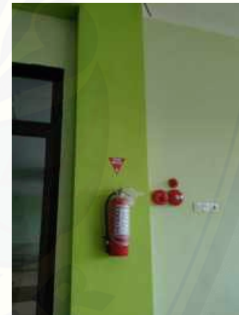
(d) Sistem Hydrant Lantai 1
