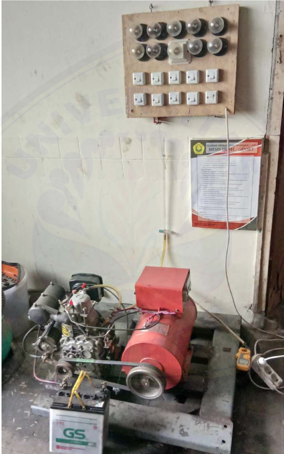
Gambar 1. Instalasi alat pengujian unjuk kerja mesin diesel
