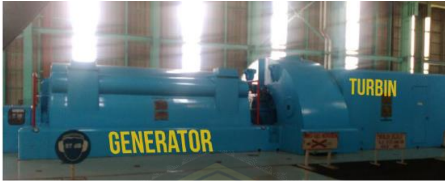
Gambar 2. 8 Turbin uap dan generator
