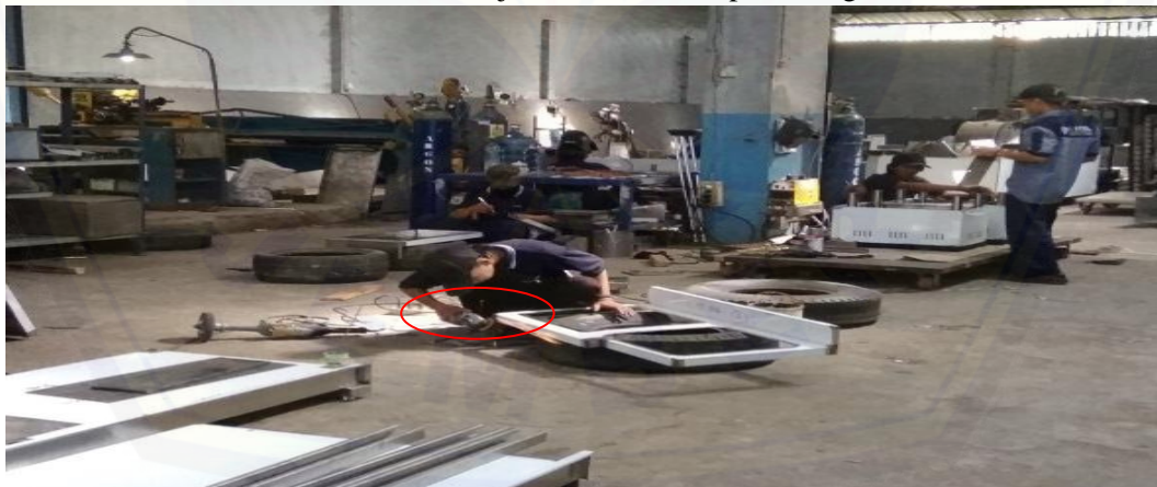
Gambar 16. Pekerja tidak memakai pelindung diri
