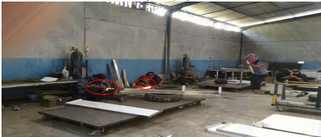
Gambar 15. Pekerja tidak memakai pelindung diri
